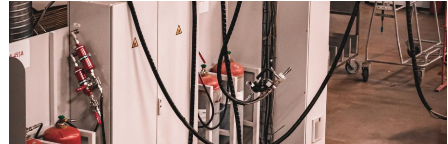
Machine de charge et detection de fuites
